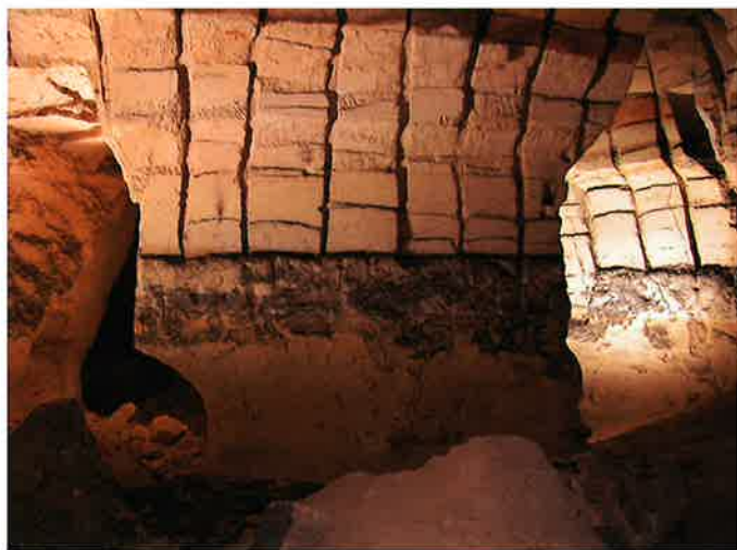
Figuur 11. Instabiliteitszone in de Grote Kuil met aanwijzingen voor dakbreuk (grote afgevalen blokken), al heeft het hoge dak vooralsnog standgehouden. Op de wand zijn de uitgezaaide blokken goed waar te nemen, boven een voor productie van kalkgruis sterk uitgediepte laag met rooibouw (versmalling van pilaarbasis). Exploitatie van kalk voor bemesting na de bouwsteenproductie is hier duidelijk de oorzaak van de instorting en het nog bestaande risico. (foto David Lagrou)
